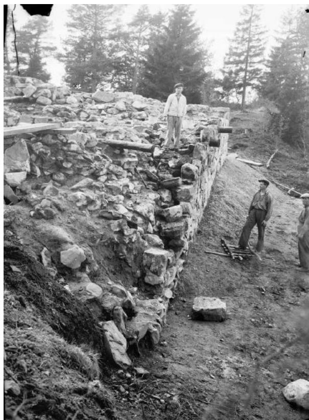
Restaurering av västra och norra muren på Dalaborgs fästning, Bolstads socken den 12 oktober år 1938. Foto: Nils Ivan Svensson, Vänersborgs museum.
